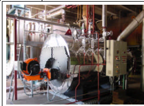
Photo 2 : chaudière bioaz à l'usine SVTA
