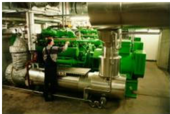
CENTRALE DE COGENERATION DU JARDIN BOTANIQUE
