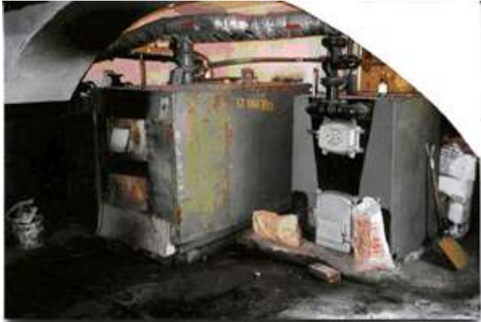
CALDERA EN LA CALLE OKREZNA ANTES DE LA MODERNIZACIÓN
