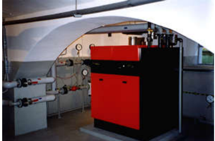
CALDERA EN LA CALLE OKREZNA DESPUÉS DE LA MODERNIZACIÓN
