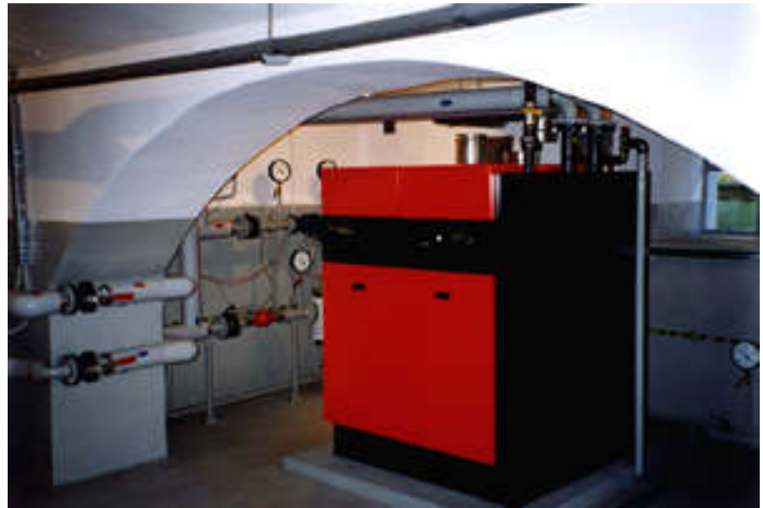
DER KESSEL IN DER OKREZNA-STRASSE NACH DER MODERNISIERUNG
